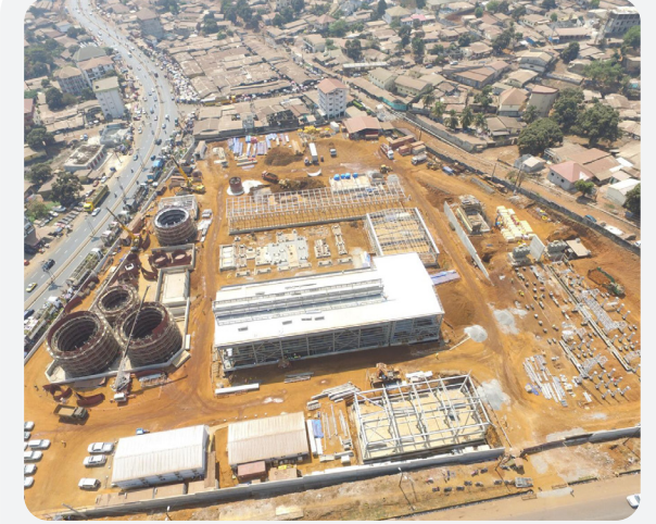
50 MW AĞIR YAKIT (HFO) SANTRALİ ve TRAFO MERKEZİ PROJESİ
