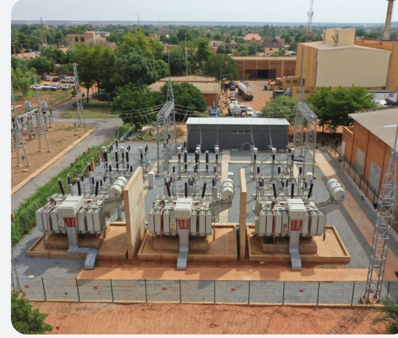
NIGELEC GOUDEL 50 MW AĞIR YAKIT (HFO) SANTRALİ 132/27,5 KV TRAFO MERKEZİ
